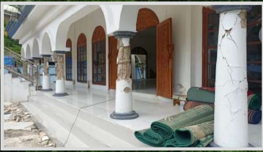
Hampir semua pilar Mesjid Dedawang Tambak di sisi timur dan utara mengalami kerusakan pada ketinggian yang sama dari tanah
