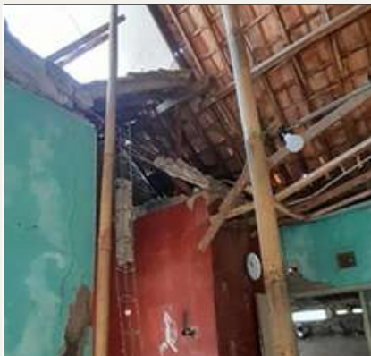
Kerusakan rumah penduduk akibat gempa bumi di Desa Menguneng, Warungasem.
