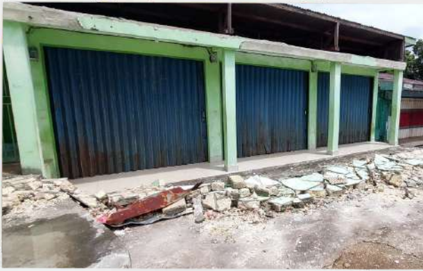
Kerusakan ruko depan Universitas Yapis, Jayapura
