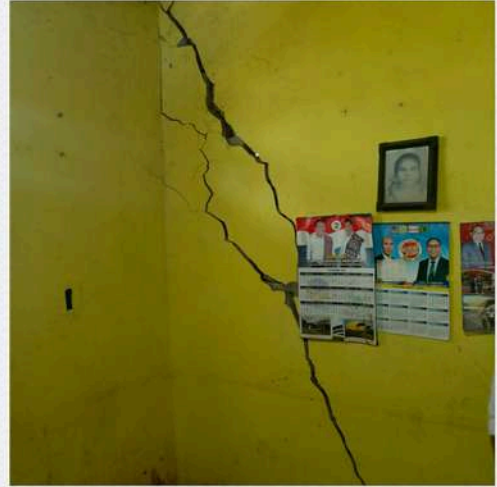
Kerusakan rumah akibat gempa bumi di Desa Retaen, Amarasi Selatan.
