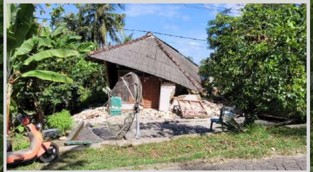
Rumah rusak berat di Desa Dekat Agung, Sangkapura.
