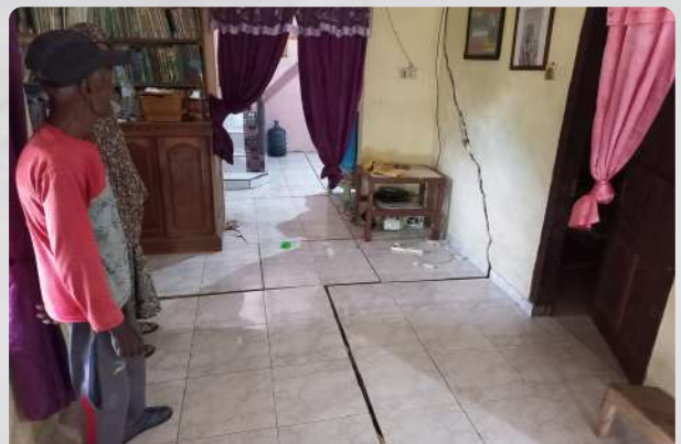
Selain itu bahaya ikutan likuefaksi turut mengontrol kerusakan bangunan di Desa Lebak, Sangkapura
