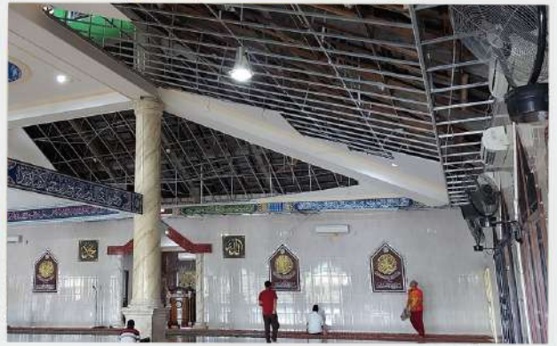
Masjid Nurul Iman Jayapura yang rusak akibat guncangan gempa bumi
