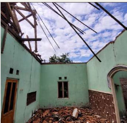
Kerusakan bangunan akibat gempa bumi di Desa Sukaraharja, Cibeber, Kabupaten Cianjur.
