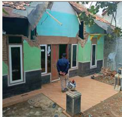
Kerusakan rumah penduduk akibat gempa bumi di Desa Cepokokuning, Batang.
