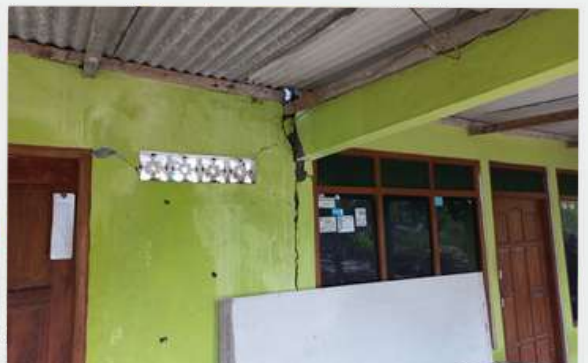
Retakan dinding pada rumah penduduk di Desa Pacarejo, Semanu, Kabupaten Gunungkidul, Provinsi DIY
