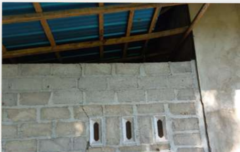
Retakan pada dinding rumah akibat gempa bumi. Desa Gunung Batu, Binuang, Kabupaten Tapin, Prov. Kalimantan Selatan
