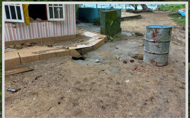
Likuefaksi akibat gempa bumi di Dusun Raba, Desa Lebak, Sangkapura
