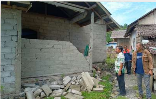
Kerusakan rumah penduduk akibat gempa bumi di Dusun 2, Desa Pomolulu, Balaesang Tanjung, Kab. Donggala
