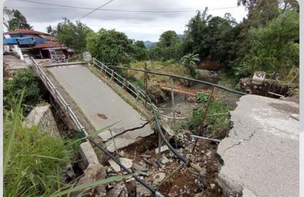
Kerusakan infrastruktur di Pesisir Selatan, Sumatra Barat. Maret 2024
