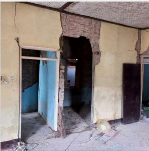
Kerusakan rumah penduduk di Kelurahan Cipameungpeuk, Sumedang Selatan akibat gempa bumi. Kelurahan Cipameungpeuk, Sumedang Selatan, Sumedang, Prov. Jawa Barat
