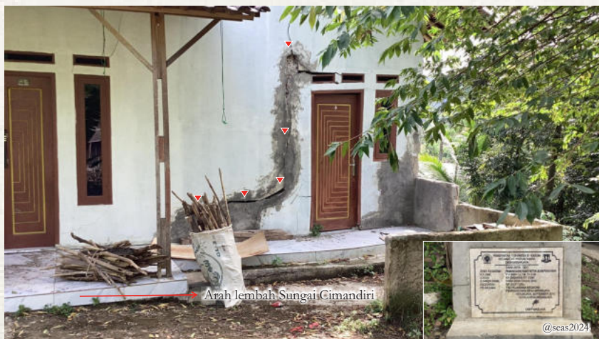
Gambar 6.30. Salah satu rumah penduduk yang mengalami retakan akibat longsoran yang sering terjadi (lihat tanda panah merah di Gambar 6.29 (b)) di daerah Desa Mekarjaya, Kecamatan Warungkiara (Foto: Sukahar Eka A. Saputra, 2024).
