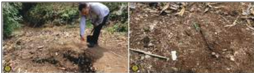
Gambar 5.18 Rekahan permukaan ( surface rupture ) akibat gempa Sumedang 31 Desember 2023 di Dusun Babakanhurip, Kelurahan Kotakaler, Kecamatan Sumedang Utara. Foto: Sukahar Eka, 2024.
