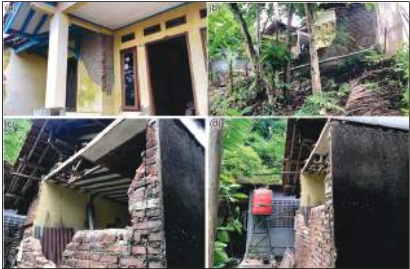
Gambar 6.4 Kerusakan di Dusun Babakanhurip Kotakaler yang mengalami kerusakan skala V-VI MMI
