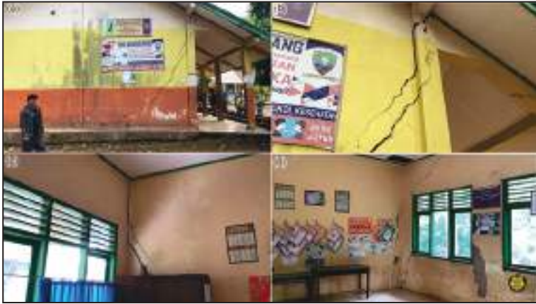
Gambar 5.28 Kerusakan bangunan SD Nanggerang, Desa Cinangsi, Kecamatan Cisit. Lokasi kampung ini sekitar 15 km dari pusat gempa ke arah tenggara. (a) dan (b) kerusakan yang terjadi di luar bangunan, (c) dan (d) suasana dan kerusakan di dalam kelas. Foto: Sukahar Eka, 2024.
