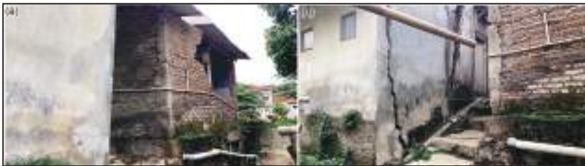
Gambar 6.8 Kerusakan sedang terjadi pada rumah penduduk di Lingkungan Cipameungpeuk RT.01/RW III, Kelurahan Cipameungpeuk, Kecamatan Sumedang Selatan (Skala V MMI).
