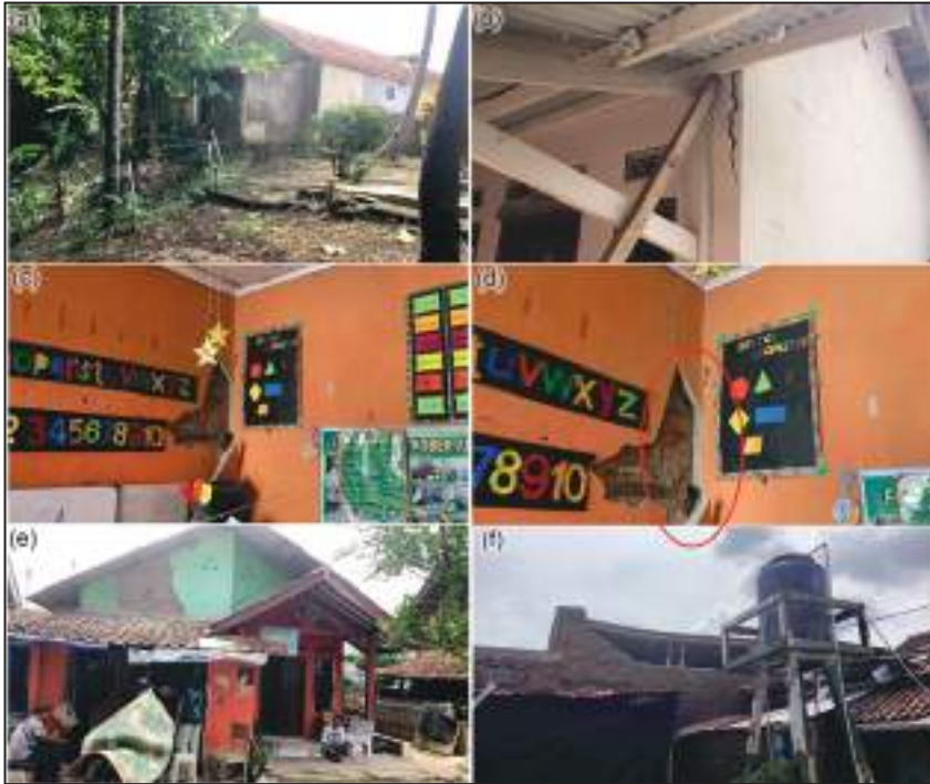
Gambar 6.2 Kerusakan di Dusun Babakanhurip, Kotakaler yang mengalami kerusakan skala V - VI MMI. Guncangan gempa tidak sampai menjatuhkan penampungan air (f), berarti gempa tersebut masih dibawah Skala VIII MMI.
