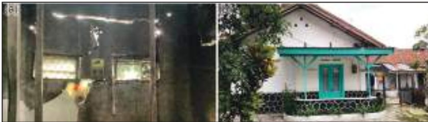
Gambar 6.7 Kerusakan sedang terjadi pada rumah penduduk di Kotakulon (Skala III MMI), namun rumah tua masih berdiri dan tidak mengalami kerusakan karena bangunan tersebut mempunyai struktur bangunan cukup kuat.
