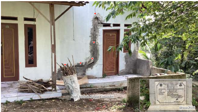
Gambar 6.30. Salah satu rumah penduduk yang mengalami retakan akibat longsoran yang sering terjadi di daerah Desa Mekarjaya, Kecamatan Warungkiara.
